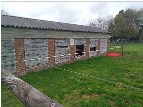
Foto 11: schuur achter Hoofdstraat 44 met in rood de globale ligging van de aangetoonde verontreiniging
