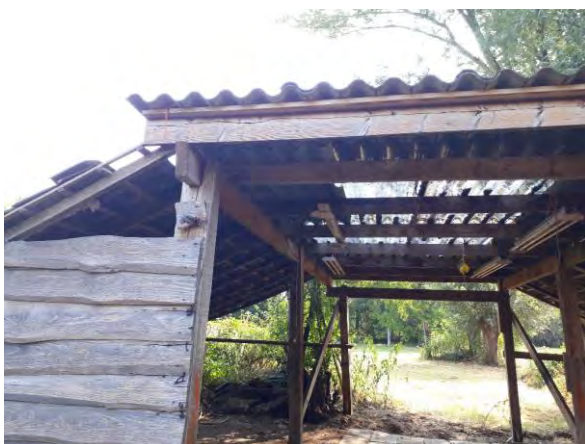
Foto 11: Verbindingsweg 17, schuur met asbestverdachte asbesthoudende golfplaten
