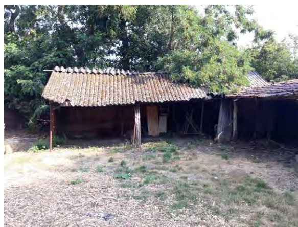
Foto 12: Verbindingsweg 17, schuur met asbesthoudende golfplaten
