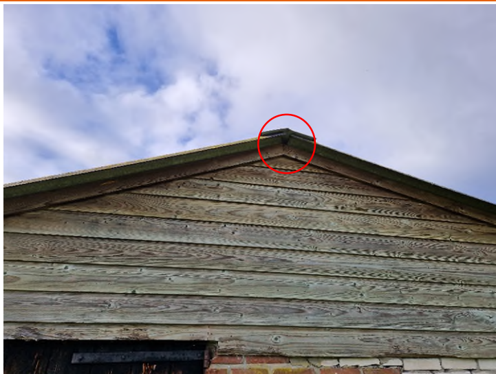
Figuur 16 Een schuur binnen deelgebied 1, ten zuiden van Hoofdstraat 44, heeft wegruimtes ter hoogte van de dakrand (rood omcirkeld); aanwezigheid van verblijfplaatsen van vleermuizen is niet uitgesloten.
