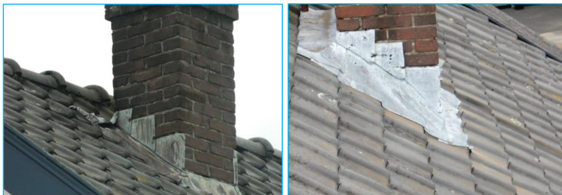
Foto's: openingen bleken na controle niet geschikt voor vleermuizen.
