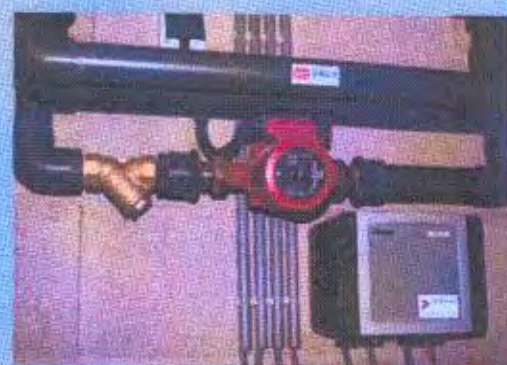
Een eenvoudige cv-pomp zorgt dat het water in een rondpompsysteem voortdurend in beweging is.
