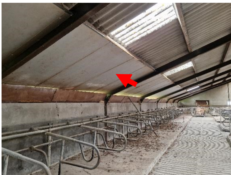
Figuur 10 Isolatieplaten ter hoogte van de dakgoot (zie rode pijl) kunnen ook via binnenzijde bereikt worden door broedvogels, zoals huismus en steenuil, waar genesteld kan worden
