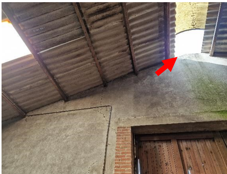
Figuur 8 Opening in dak (zie rode pijl) waardoor binnenzijde schuur bereikbaar is voor vogels
