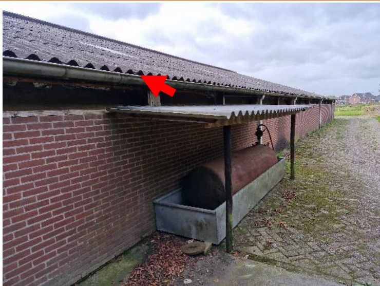
Figuur 9 Via eerste rij dakplaten (zie rode pijl) is het voor bijvoorbeeld huismus mogelijk om op de isolatieplaten te nestelen, zie ook Figuur 8
