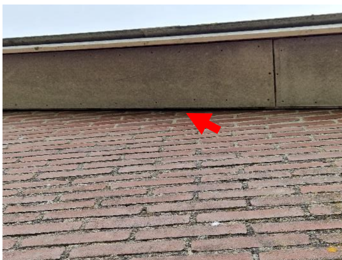
Figuur 14 Spleetvormige ruimtes ter hoogte van het overstek (zie rode pijl) vormen mogelijk toegang tot een verblijfplaats van vleermuizen
