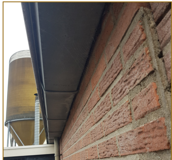
Afb. 2.4: Geen ruimte voor vleermuizen om onder de dakgoot te kruipen.
