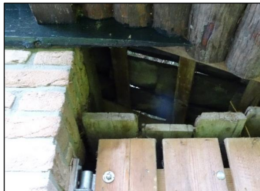
Fig. 2.10 Afwezig zijn van dakbeschot in gebouw nr. 3 (bron: FF Solutions)
