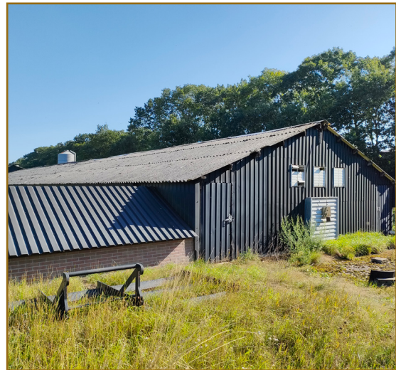
Afbeelding. 4.4: Schuur B gezien vanaf het zuiden. Gevelbekleding is vrijwel rondom metalen damwand, daardoor ongeschikt voor vleermuizen.
