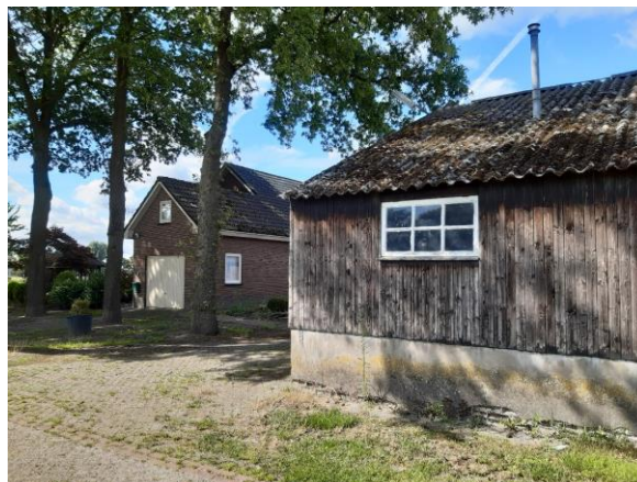
Foto 10: Meest oostelijke stal met sterk verweerde (asbestverdachte) dakbedekking waaronder de waterafloop terecht komt op een klinkerverharding.
