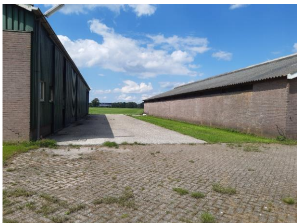
Foto 3: Twee schuren waarvan de linker schuur (asbest)onverdacht is en de drupzone ter plaatse van rechter schuur wel (asbest)verdacht is.
