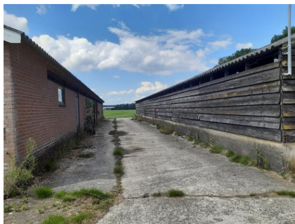
Foto 6: Twee stallen met asbesthoudende dakbedekking met onderliggend verhard terreindeel.
