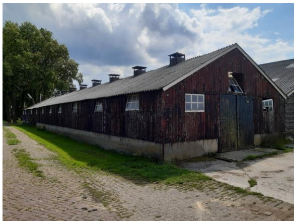
Foto 9: Meest verdachte stal met sterk verweerd asbestverdachte dakbedekking.
