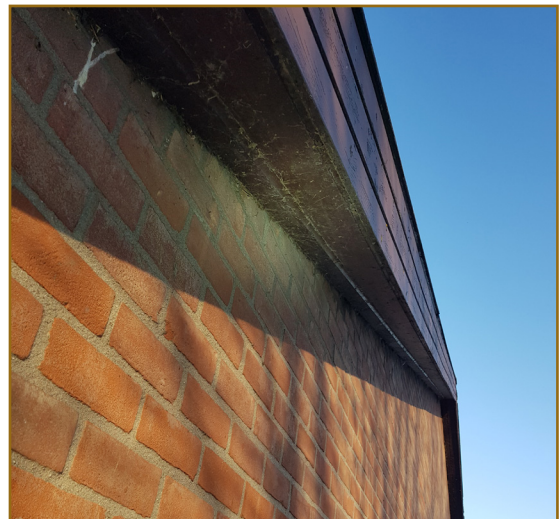
Afb. 2.4: Bij schuur 14 zit het overstek strak tegen de muur aan waardoor er geen ruimte is voor vleermuizen.
