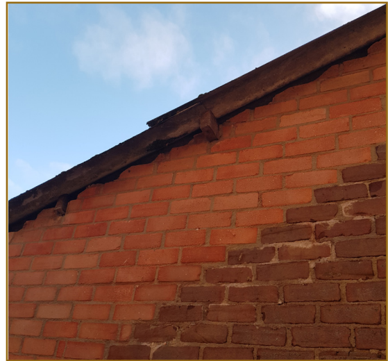
Afb. 2.2: Ruimte tussen de muur en de dakplaten van schuur 7B maar er is geen spouw aanwezig.
