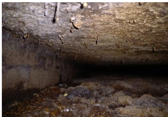
Foto 10: Onderzijde betonvloer van kelderdek t.p.v. schuur 1.
