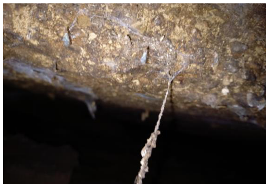
Foto 9: Onderzijde betonvloer van kelderdek t.p.v. schuur 1.
