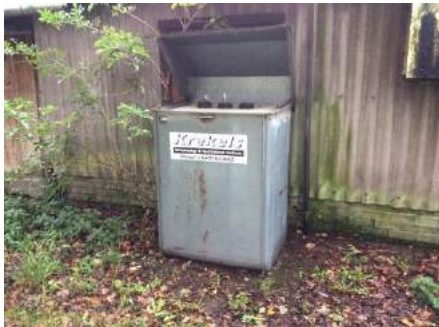
Figuur 14: Bovengrondse tank
