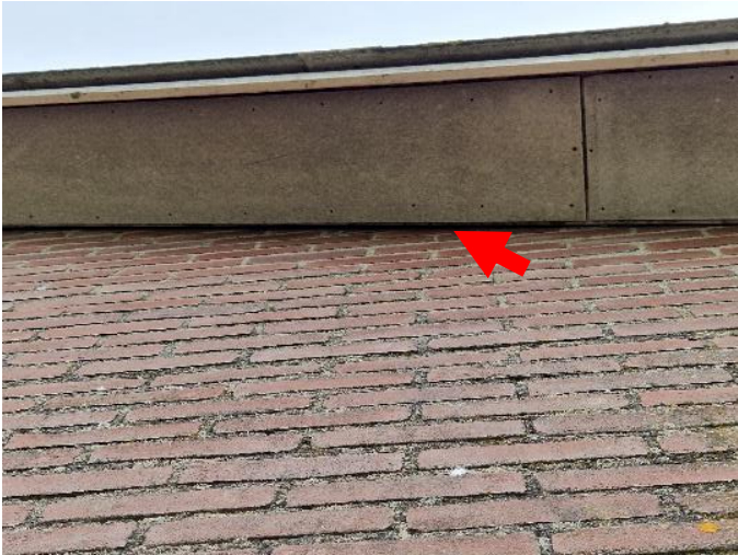
Figuur 32 Spleetvormige ruimtes ter hoogte van het overstek (zie rode pijl) van voormalige koeienstal van Bloemendaallaan 77 vormen mogelijk de toegang tot een verblijfplaats van vleermuizen
