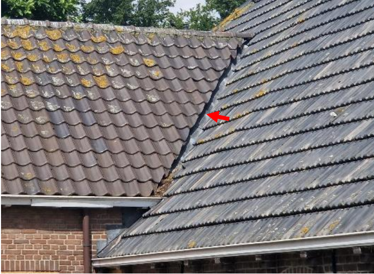
Figuur 24 Via openingen bij de dakrand van Nijkerkerweg 128 (zie rode pijl) kunnen grondgebonden zoogdieren zoals steenmarter en boomarter mogelijk in het gebouw verblijven
