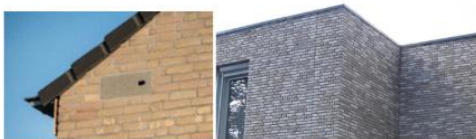
Figuur 6. Voorbeeld van inbouwvoorziening prefab kast model GZP2 van de firma Unitura (links) en praktijkvoorbeeld van Arcadis (rechts).
