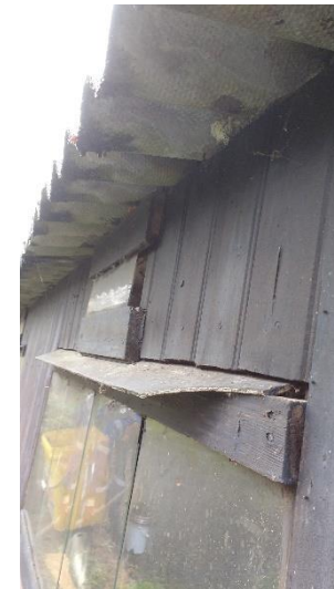
Foto 12: Asbestverdacht materiaal schuur 45-50
