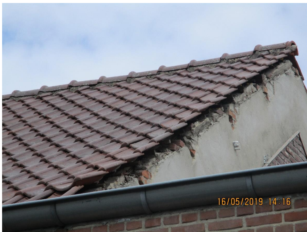
Figuur 2 Doordat de bebouwing reeds deels is gesloopt, is een deel van het dak blootgelegd. Hierdoor ontstaan er tochtstromen en is de ruimte onder het dak ongeschikt voor vleermuizen.
