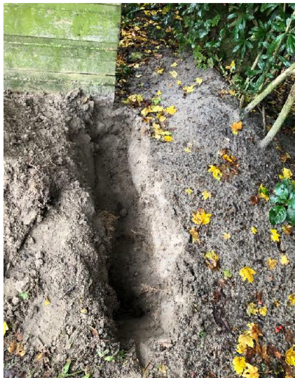
Aan de zandbakzijde is sprake van een ophoging. Deze is licht doorworteld.
