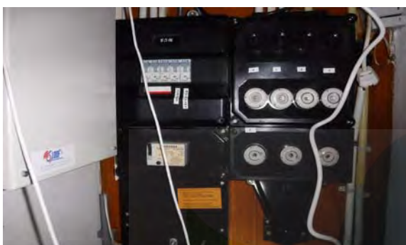
Meterkast niet asbestverdacht.
