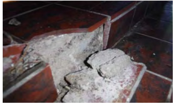
Opstort in de Cv-ruimte is niet asbestverdacht
