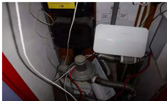
Meterkast niet asbestverdacht.
