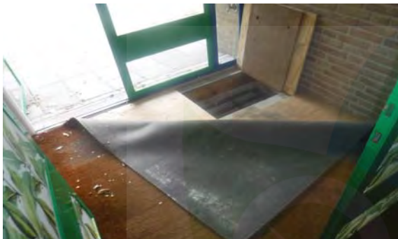
Kruipruik is niet asbestverdacht
