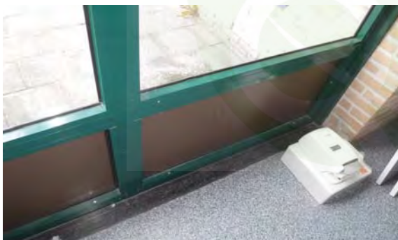
Borstweringspanelen zijn niet asbestverdacht (Trespa)
