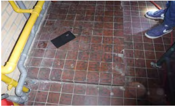
Opstort in de Cv-ruimte is niet asbestverdacht
