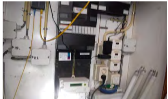
Meterkast niet asbestverdacht
