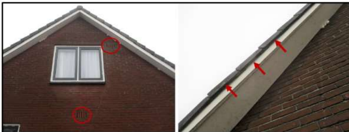
Figuur 4 Woning A biedt door open ventilatieroosters (links) en kierende kantpannen (rechts) openingen die door vleermuizen gebruikt kunnen worden om de luchtspouw of een dakruimte te bereiken.
