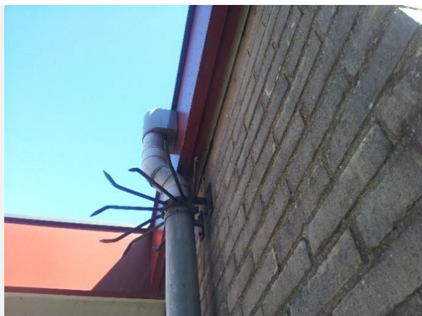
Foto 7. Openingen bij de daklijst. Potentiële verblijfplaats van vleermuizen.
