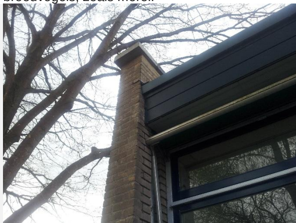
Foto 4. Opening bij de dakrand. Potentiële verblijfplaats van vleermuizen.
