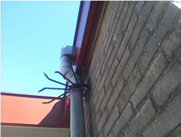
Foto 7. Openingen bij de daklijst. Potentiele verblijfplaats van vleermuizen.
