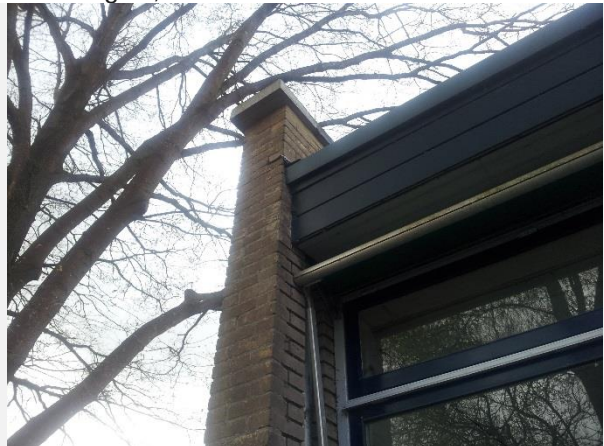
Foto 4. Opening bij de dakrand. Potentiele verblijfplaats van vleermuizen.
