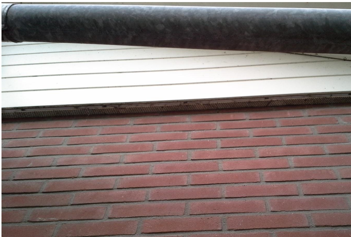
Fig. 5-1. Betimmering aan zuidoostzijde van stal. Deze sluit direct aan op de muur waardoor het niet toegankelijk is voor vleermuizen.
