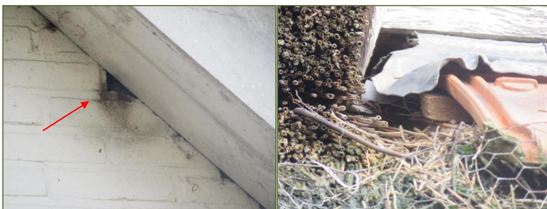
Foto's: Opening in rieten dak en opening voorzijde woning met duidelijke gebruikssporen.
