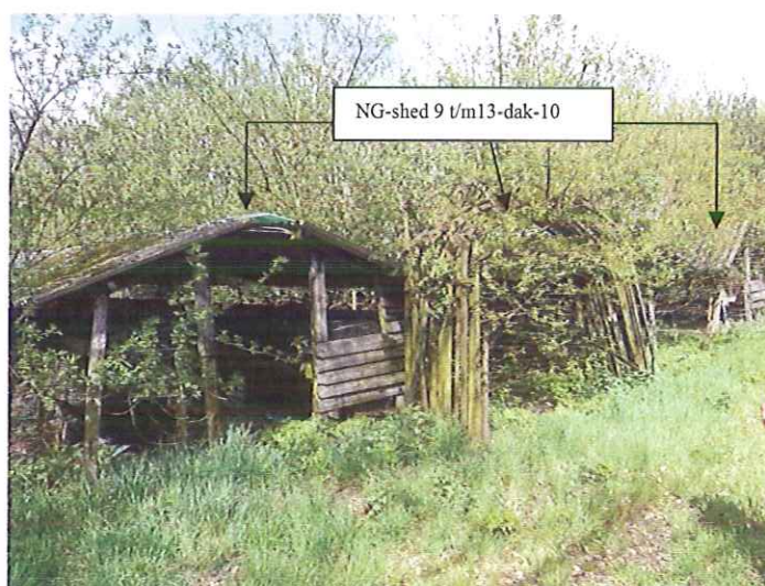
Foto 17: Geïntervieweerde shed 9 t/m 13 met asbesthoudende golfplaat als dakbedekking vanuit zuidwestelijke richting gezien.
