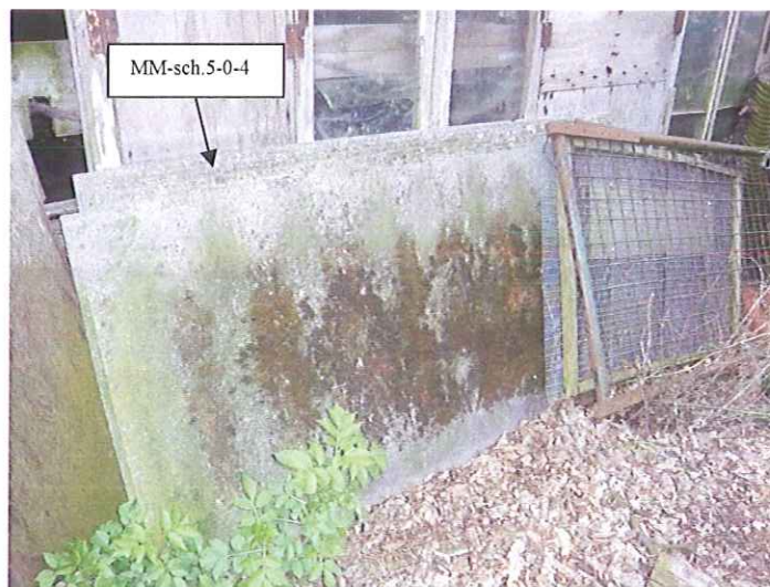
Foto 10: Losstaand asbesthoudend plaatmateriaal tegen gevel van schuur 5.
