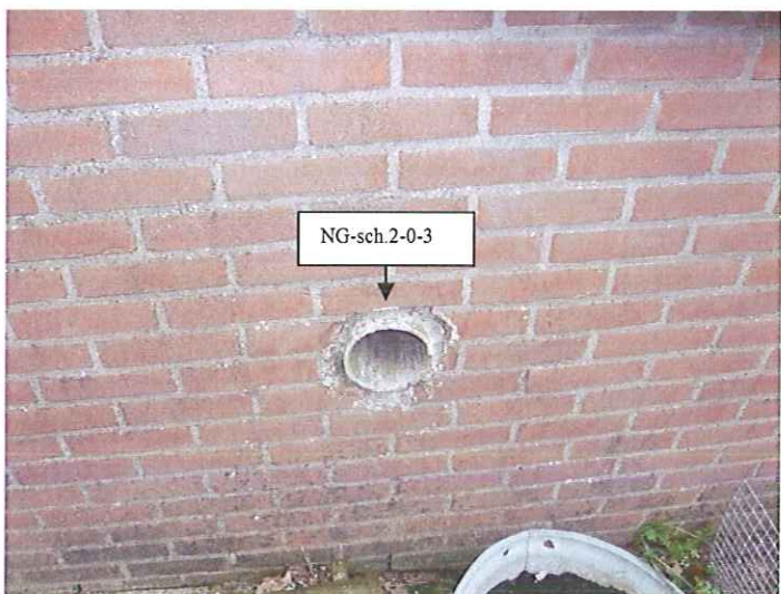
Foto 6: Asbesthoudend buismateriaal als doorvoer in gevel van schuur 2.
