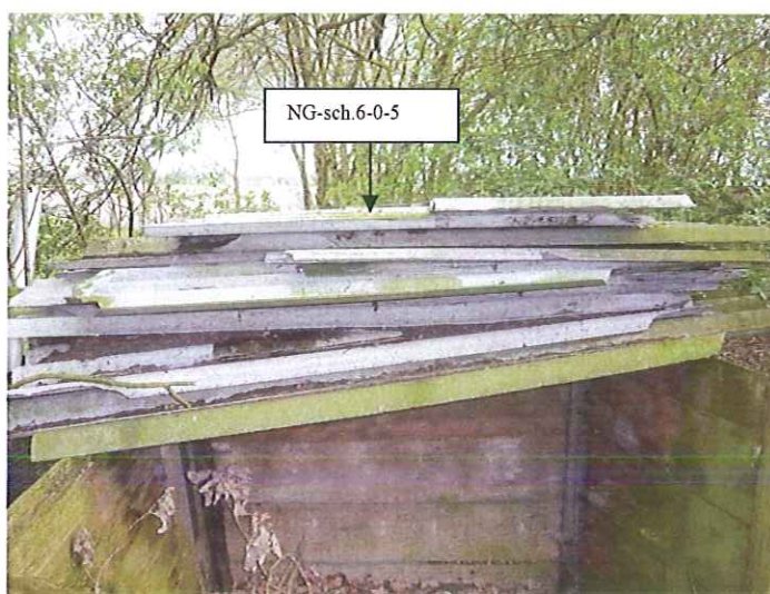
Foto 12: Losstaande asbesthoudende golfplaat naast schuur 6.
