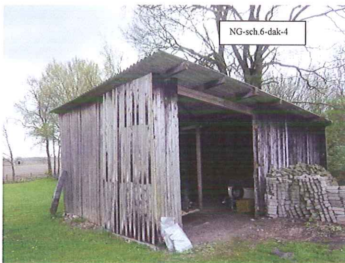
Foto 11: Geïnventarisierde schuur 6 met asbesthoudende golfplaat als dakbedekking vanuit noordelijke richting gezien.
