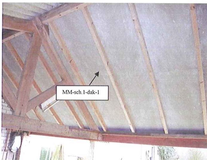
Foto 3: Asbesthoudend plaatmateriaal als gedeeltelijk dakbeschot van schuur 1.
