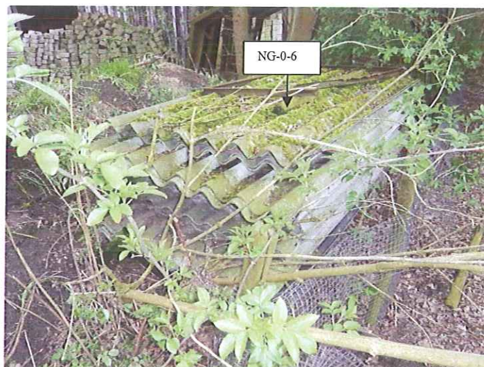
Foto 13: Losstaande gestapelde asbesthoudende golfplaat tussen schuur 5 en 6.
