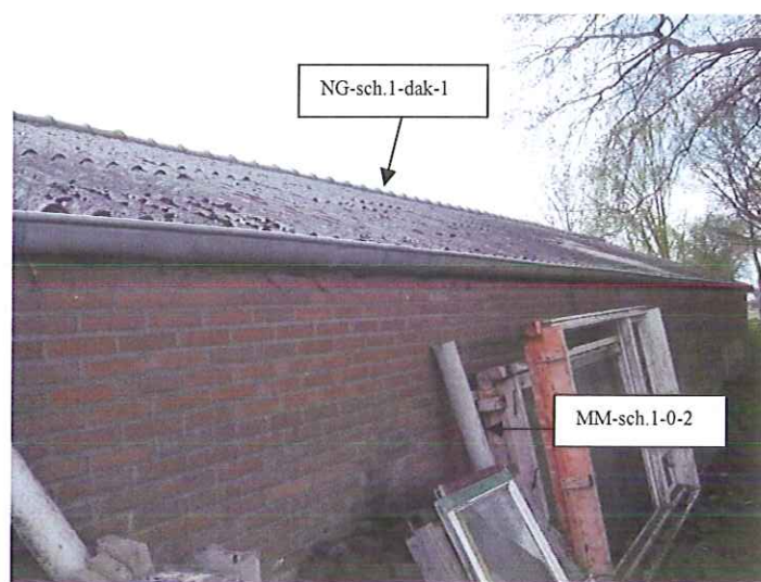
Foto 4: Asbesthoudende golfplaat als dakbedekking en asbesthoudende schoorsteenpijp losstaand t.p.v. schuur 1.
