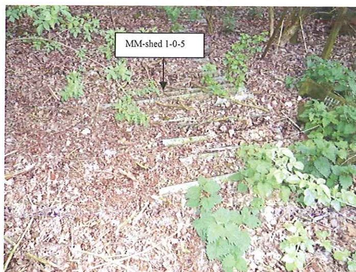
Foto 15: Losliggende asbesthoudende golfplaat op maaiveld ter plaatse van shed 1.
