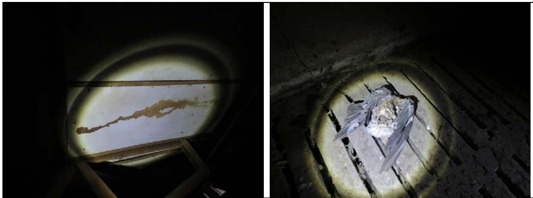
Figuur 2.1. Gevonden sporen (links urinesporen, rechts aangevroten duif) in de te slopen bebouwing.
