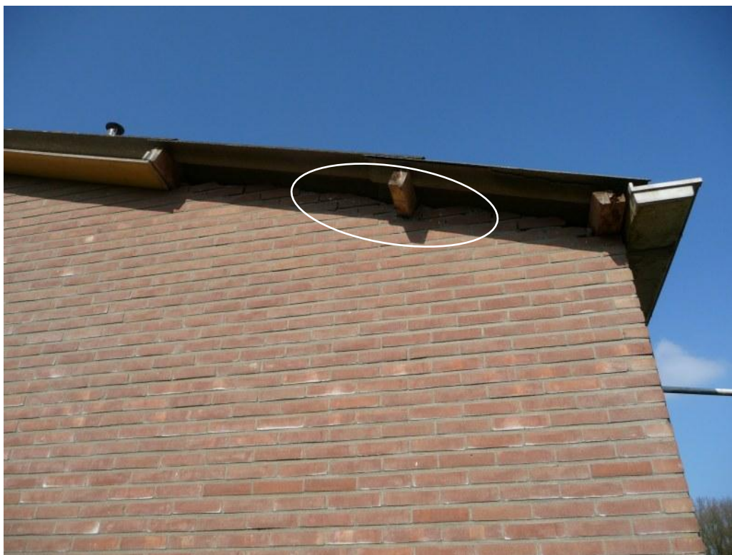
Foto 4. nestlocatie huismus, tevens toegang tot spouw voor vleermuizen
