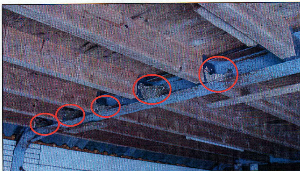
Foto 13. Enkele van de waargenomen zwaluwnesten in een stal.
