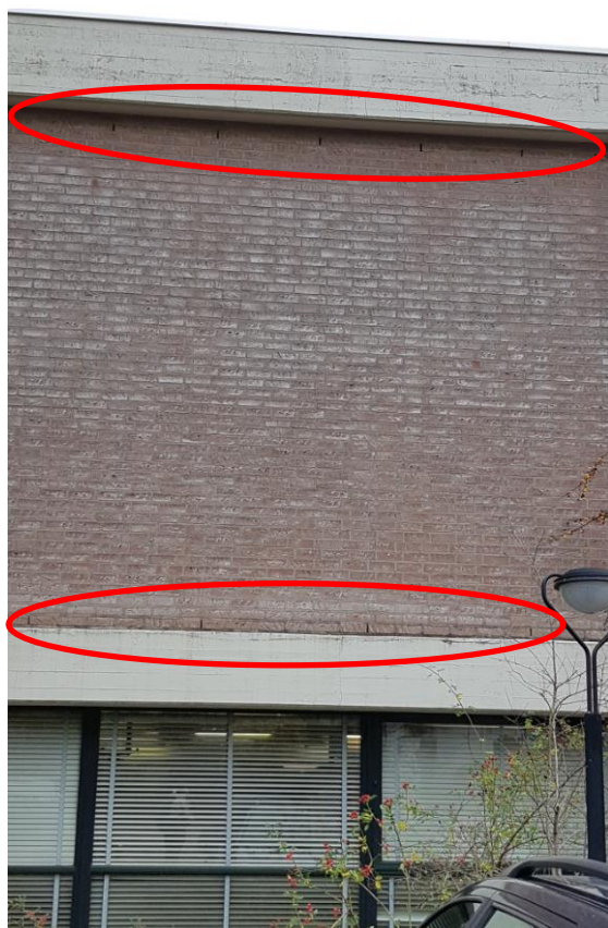
Figuur 5. Open stootvoegen in het conferentiecentrum die vleermuizen toegang kunnen bieden tot het gebouw.
