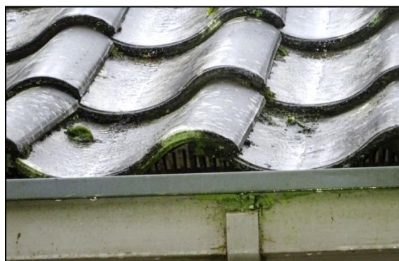
Figuur 11. Vogelschroot onder de eerste rij dakpannen.
