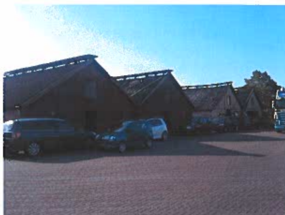
Foto 4: Nog bestaande stallen met beschadigde asbestdaken.
