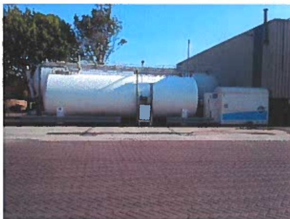
Foto 2: Bovengrondse 40.000 liter dieseltank met brandstofpomp en voorliggende was-/ tankplaats. Daarvoor de plek waar de toekomstige was-/tankplaats wordt gerealiseerd.
