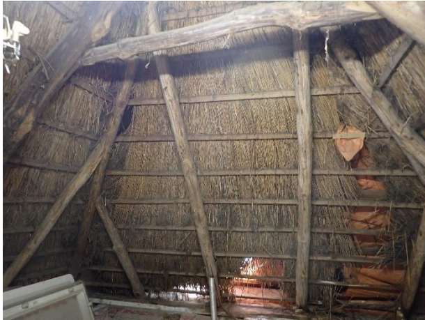
Foto 7: links, beschadigd rieten dak van de boerderij.
