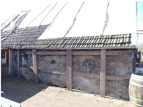
Foto 3: links, zijkant van het bakhuis met een kapot raam.
