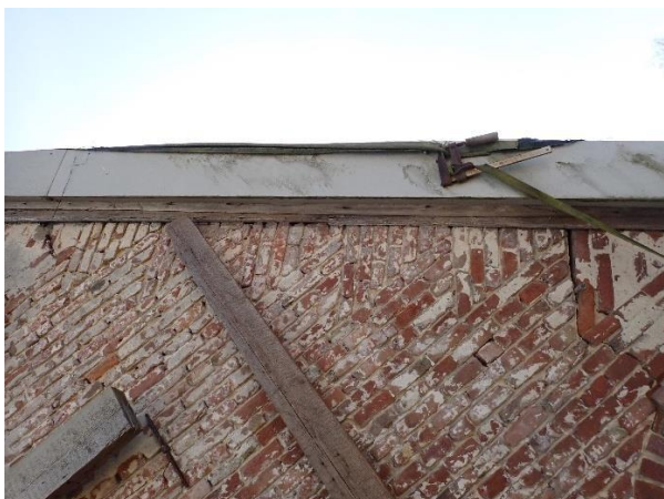
Foto 5: links, beschadigingen aan de gevel van het bakhuis.
