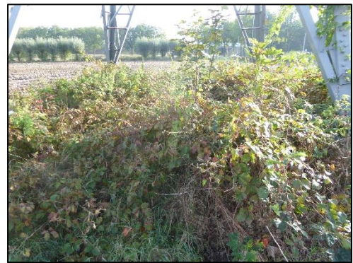
Opslag van braam onder electriciteitsmast.
