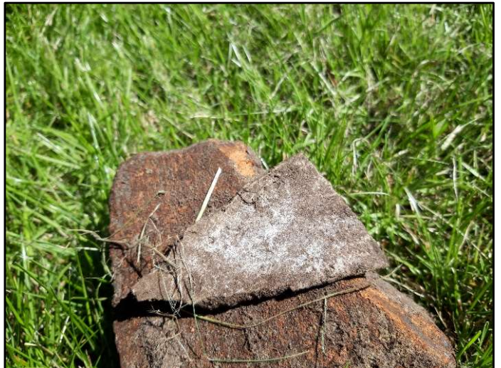
Foto 10: Asbestverdacht materiaal proefsleuf 104
