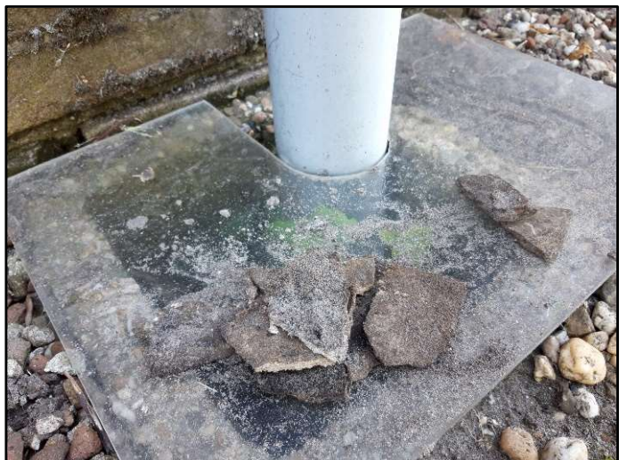
Foto 12: Asbestverdacht materiaal proefsleuf 105
