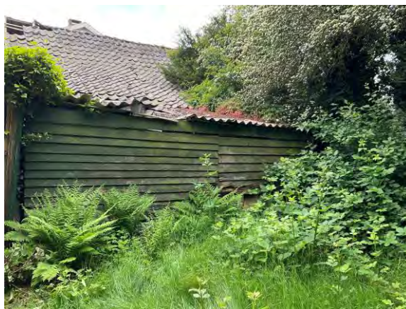
Figuur 9: Overzichtsfoto asbestverdacht dak aanbouw
