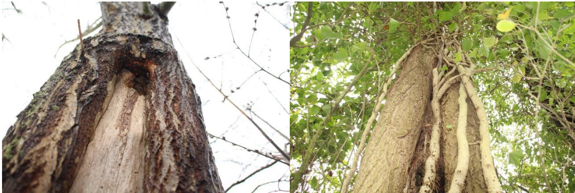
Afbeelding van twee bomen met beschadigingen in de bast. Ze worden niet beschouwd als potentiële verblijfplaats voor vleermuizen.
