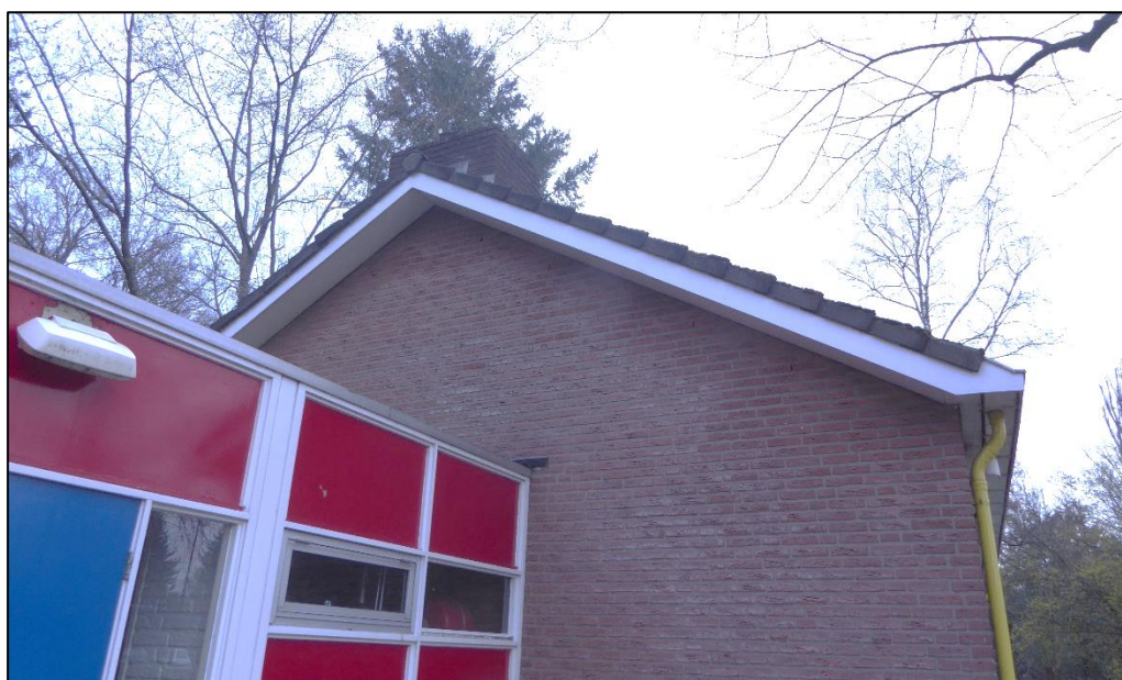
Overhangende nokpannen die een geschikte broedlocatie bieden voor gierzwaluwen.
