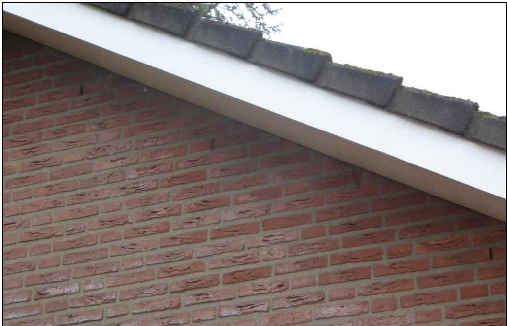
Aanwezige open stootvoegen in bebouwing. Er is ook ruimte aanwezig onder de overhangende nokpannen.
