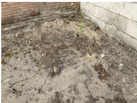
Figuur 8: Overzichtsfoto asbestverdacht materiaal
