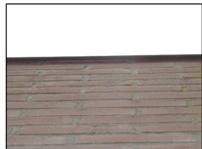
Figuur 16. Geen ruimte onder de metalen dakrand.
