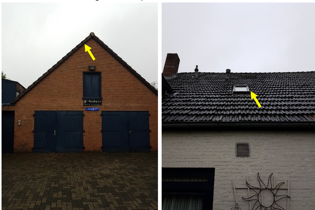
Figuur 5. Openingen onder de kantpannen van het voormalige bedrijfspand (links) en openingen langs pannen rond een raamkozijn van het woonhuis (rechts).
