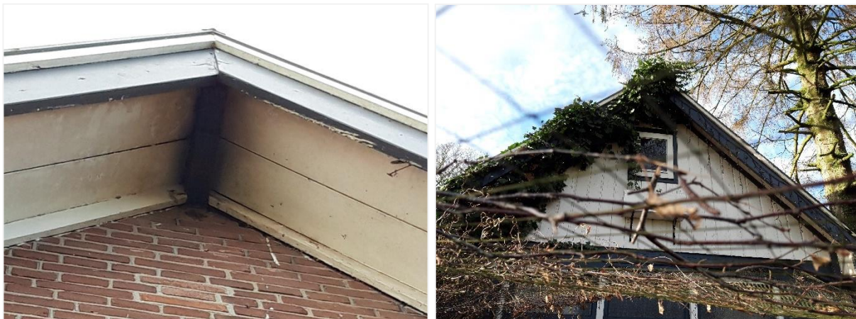
Afbeelding 5.1: Van links naar rechts: Een kierende gevellijst van de woning aan de Papegaaiweg 99 en de houten kopgevel van de woning aan de Oude Zwolseweg 147 welke op verschillende plaatsen kiert. Foto's: Natuurkompas, 2023.
