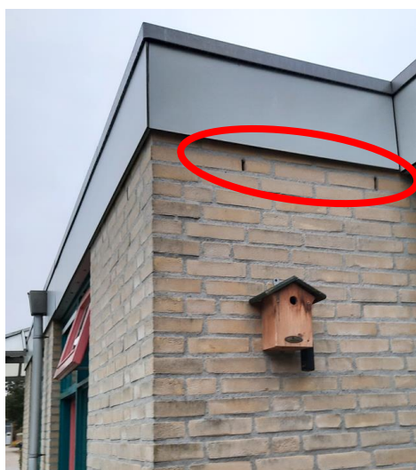
Figuur 5.1: Open stootvoegen welke een potentiële invliegopening voor een verblijfplaats in de spouw voor vleermuizen vormt
