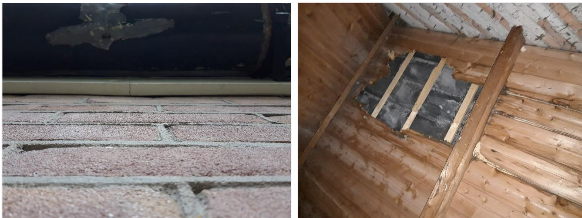
Afbeelding 5.1: Links: Detail van de daklijst. Rechts: Gat in het dakbeschot als gevolg van een omgevallen boom. Foto's: Natuurkompas, 2021.
