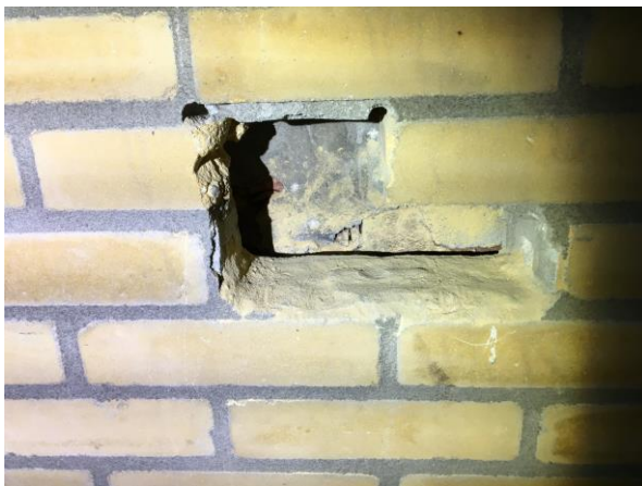
Detail van de binnenzijde van de opbouw. Duidelijk zichtbaar is het ontbreken van isolatie in de spouw.
