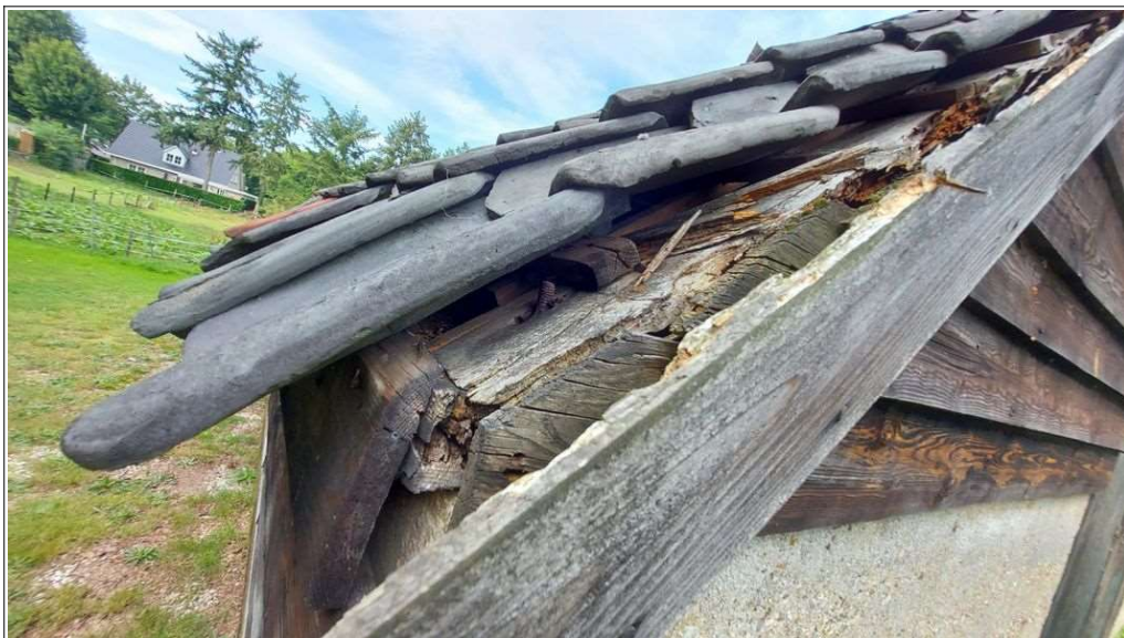
Detail van de dakrand van stal 2. De stallen zijn in zeer slechte staat en er zijn veel openingen en kieren aanwezig. Foto: M. de Vries / Ecoresult B.V.
