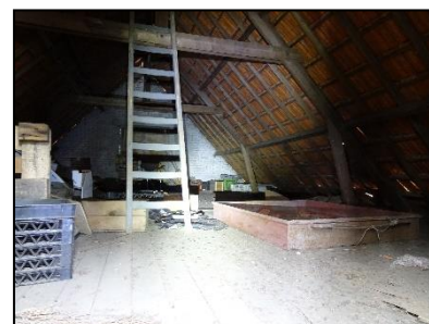
Figuur 13. Zolder van de schuur. Geen dakbeschoot aanwezig die ruimte kan bieden aan vleermuizen.
