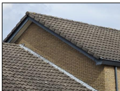
Figuur 12. Overhangende kantpannen aan het westelijke woonhuis.
