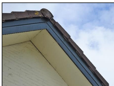
Figuur 11. Overhangende kantpannen aan het oostelijke woonhuis.
