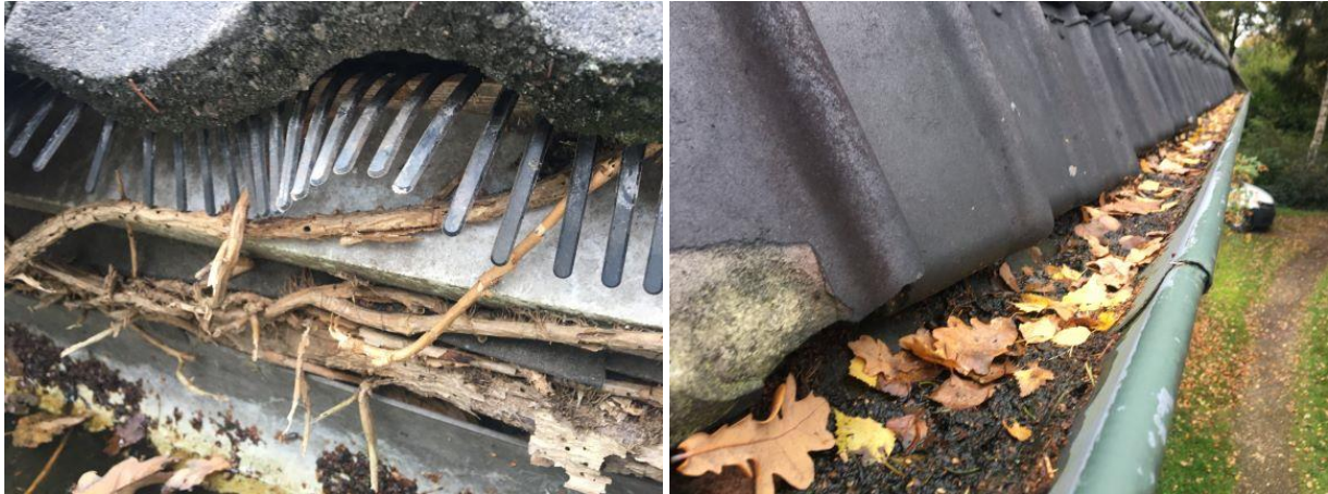
Foto links: vogelschroot onder de onderste rij dakpannen van de noordelijke woning. Foto rechts: pannen liggen diep in de dakgoot van de zuidelijke woning.
