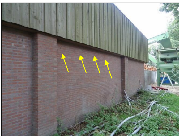
Figuur 11. Open stootvoegen in de muurdelen van de aangrenzende loods.
