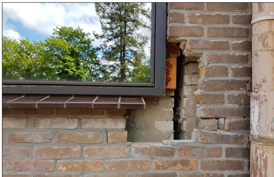
Foto 4.4.2: Groot gat in de gevel van het voormalige Sportfondsenbad.
