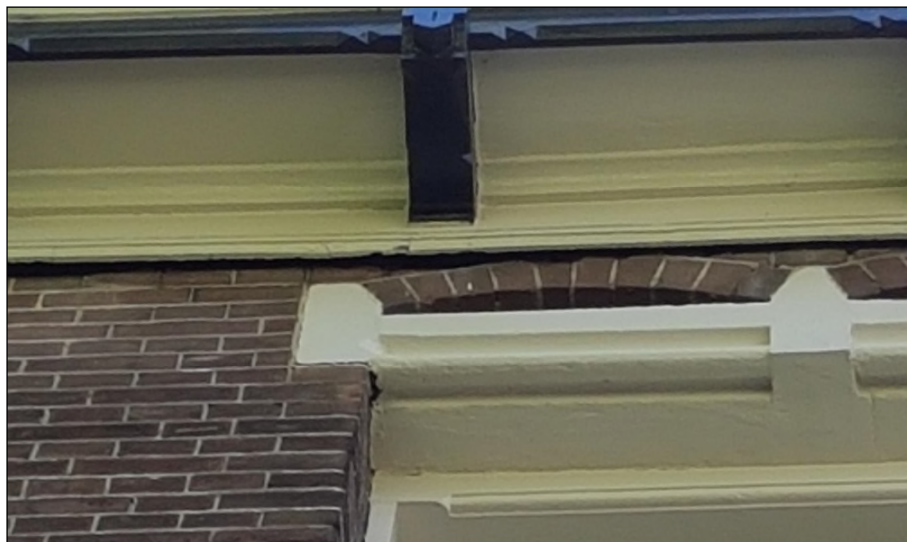
Foto 4.4.1: Ruimte achter daklijst geschikt als verblijfplaats voor vleermuizen.
