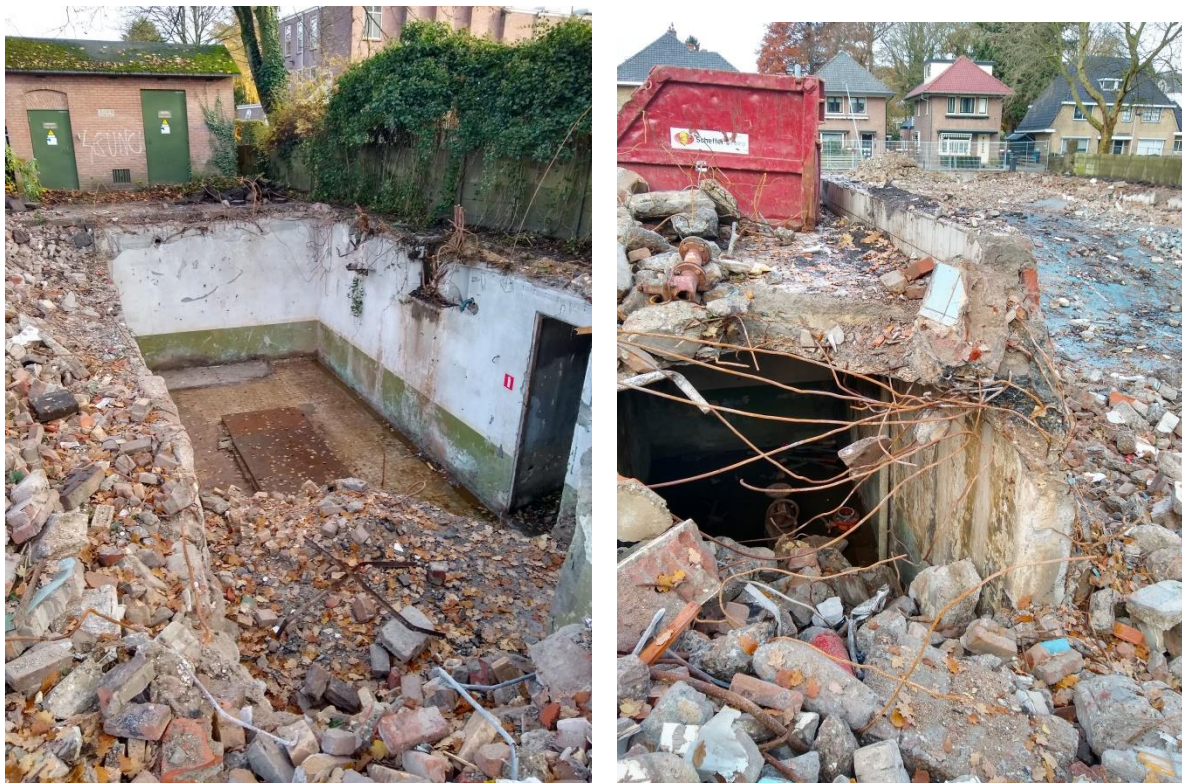
Figuur 3. Kelderruimte voor de verwarmingsketels (links) en onderhoudsruimtes rondom het grote zwembad (rechts).
